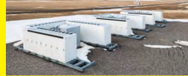
Stockage sur batteries
