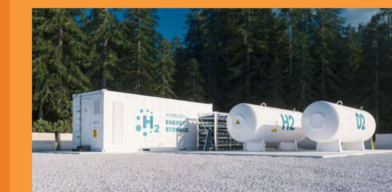
Stockage de l'hydrogène
